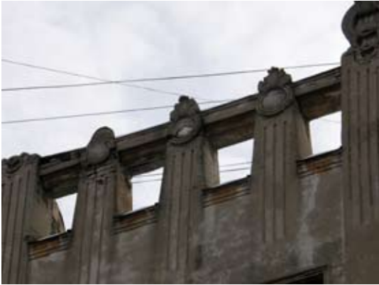
Вул. Дорошенка, 15 (майоліка зруйнована)
